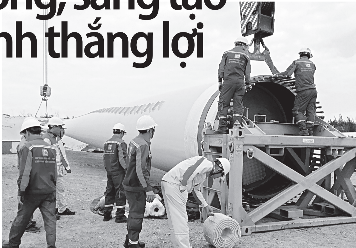
Nhiều tập cán bộ kỹ thuật và công nhân của Công ty CP Phong điện Phương Mai chuẩn bị lắp đặt các cánh quạt gió lên trụ tua bin. Ảnh: TIẾN SỸ
